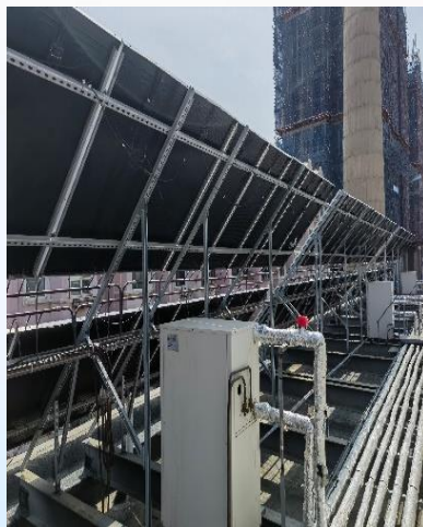
PV-T热泵系统
