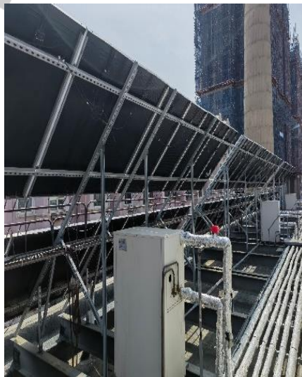
PV-T热泵系统
