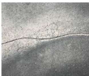
开槽后的裂缝
